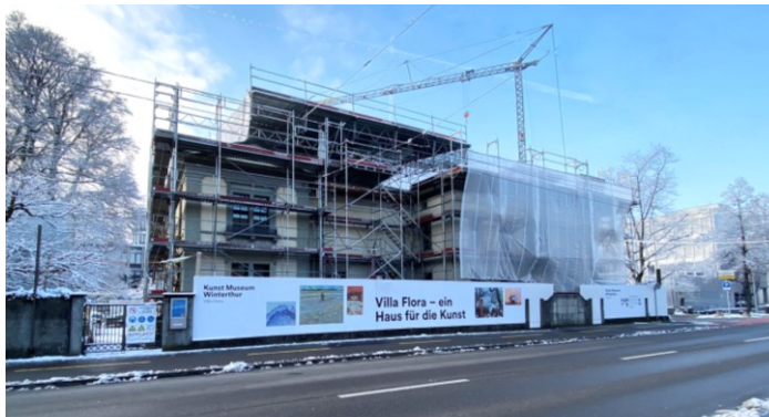
Hinter der bunt gestalteten Absperrung ist der Umbau der Villa Flora in vollem Gange.
